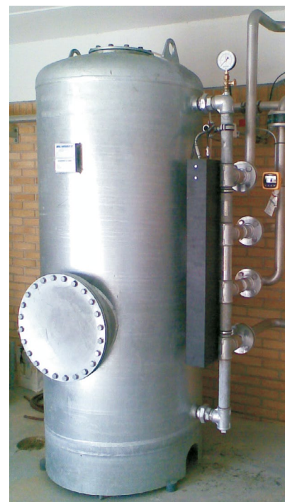
Odstraňování arzenu ve vodárně prostřednictvím adsorpce. Řešení obsahuje automatický tlakový filtr typ NSB 170 instalovaný za otevřenými gravitačními filtry. Průtok: 12 m 3 /hod.
